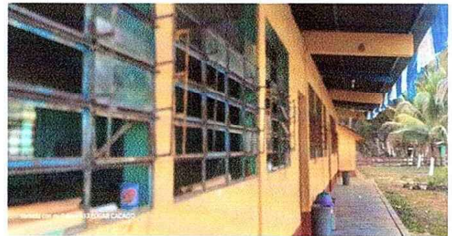
Foto 4: Se observa el deterioro de las ventanas.
