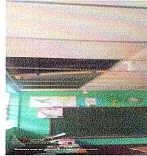
Foto 2: Se observa deterioro del cielo falso.
