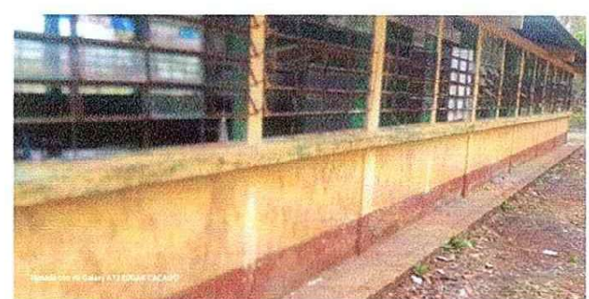
Foto 6: Se observa el deterioro de la pintura.
