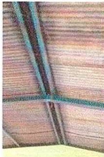
Foto 5: Se observa el mal estado del techo.
