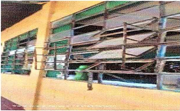
Foto 1: Se observa vidrios rotos.
