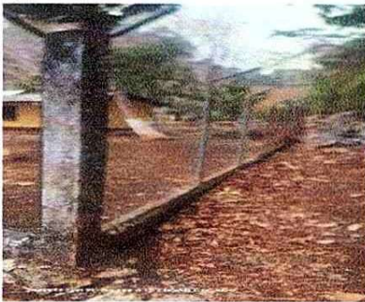
Foto 3: Se observa el mal estado de la malla perimetral.
